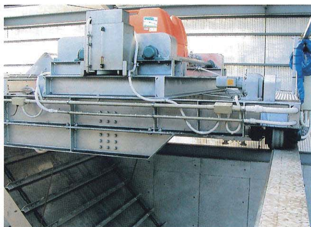
↑自動注油装置(搬送チェーンにオイルを噴霧します。)
