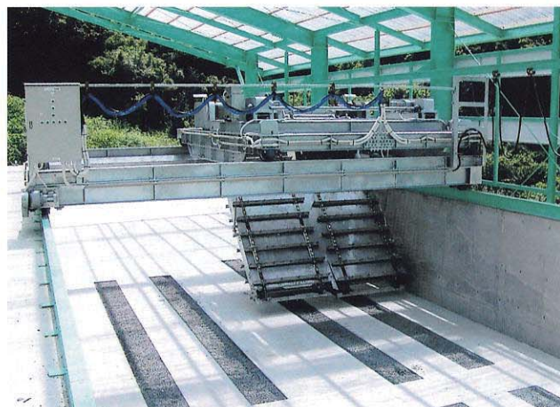
↑ステンレス鋼と溶融亜鉛めっき仕上げ
