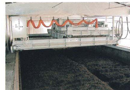
↑サークルコンポ NWZ60-23型 (切り返し機が昇降機で上部に移動)
